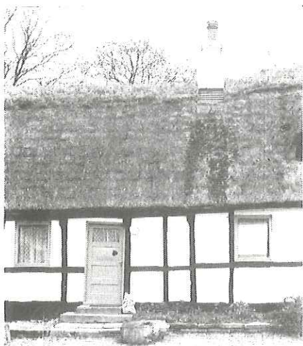
Stuehuset på Grønnebjerggård, Maglemosevej 1, har en skorsten med sokkel og udkrægning foroven. Den er idag forsynet med en keramisk pibe øverst.
